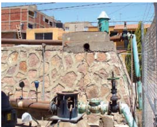
Robo de la flechas en el pozo Tecnológico
