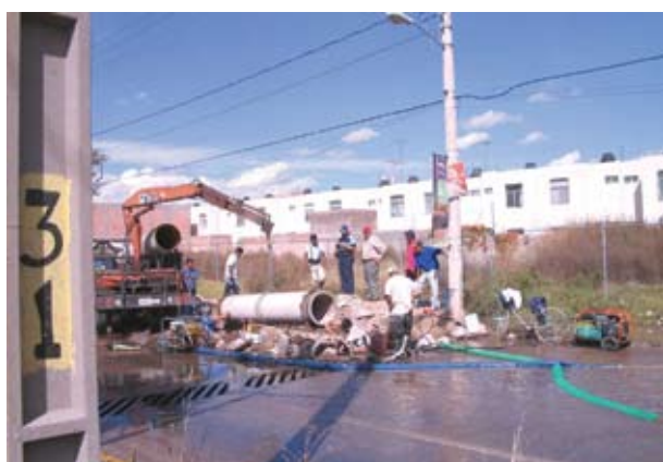
Fuga en el ducto de 24", Av. Salk
