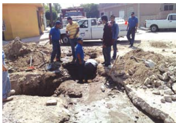
Fuga en la calle Alaska
