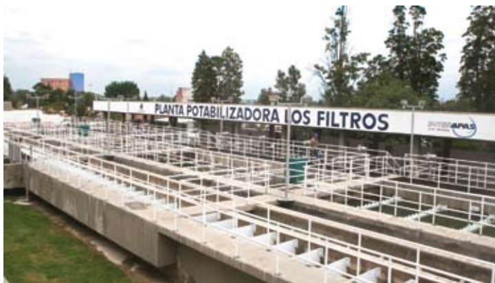
Vista panorámica de la nueva planta potabilizadora
