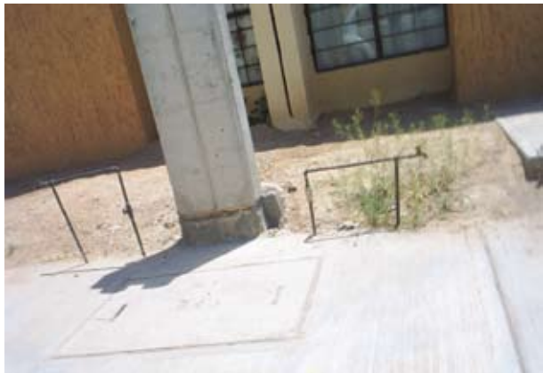
Revisión de cuadros de agua potable, Fracc. Villas del Sol
