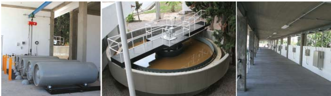
De izquierda a derecha: sistema de tanques de cloración, tanque espesador de lodos y galería de operación de filtros.
