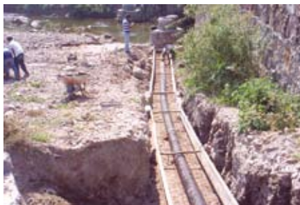
Drenaje sanitario de "Escalerillas"
