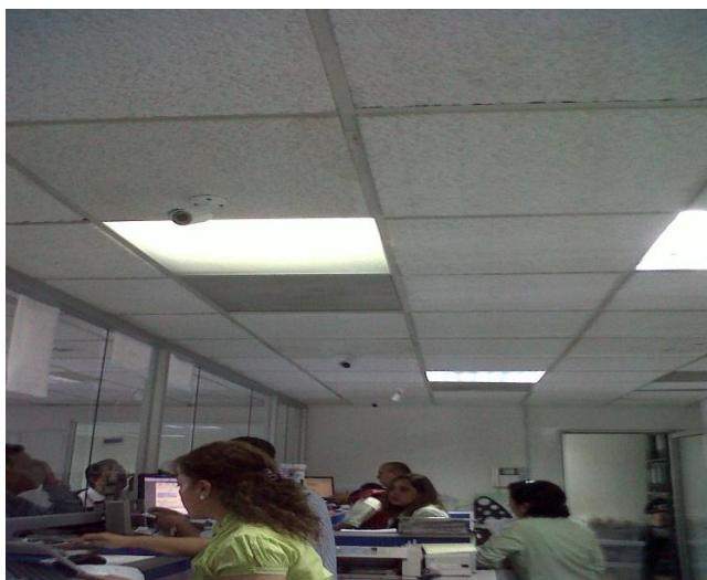
Cámaras en el área de cajas
