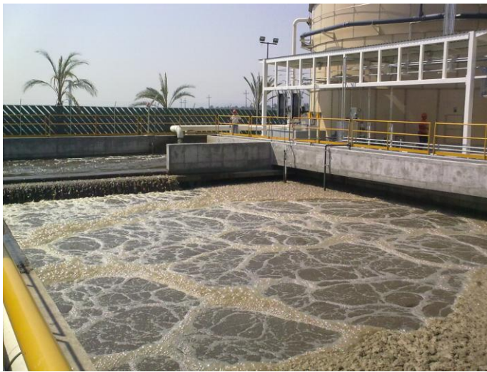
PTAR Industrial Minera México
