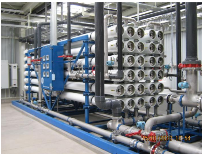
Sistema de osmosis inversa de la PTAR.
