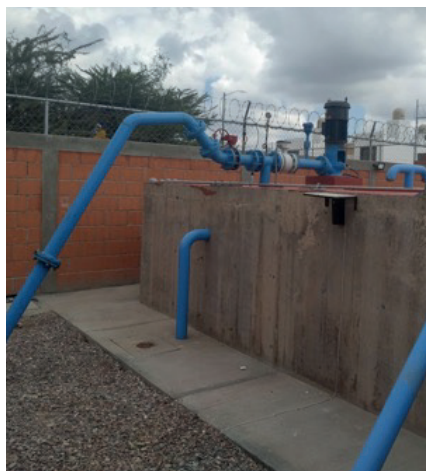
Equipamiento de rebombeo Compostela.
