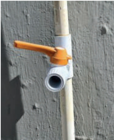
Ilustración 4. Llave para aforo de polímero coagulante en caja de mezcla
