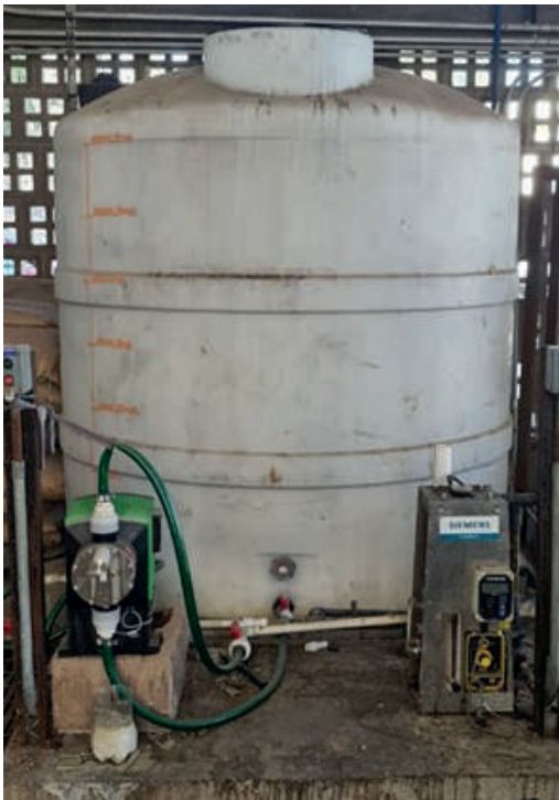
Ilustración 6. Tanque de 3000L habilitado para polímero coagulante.
