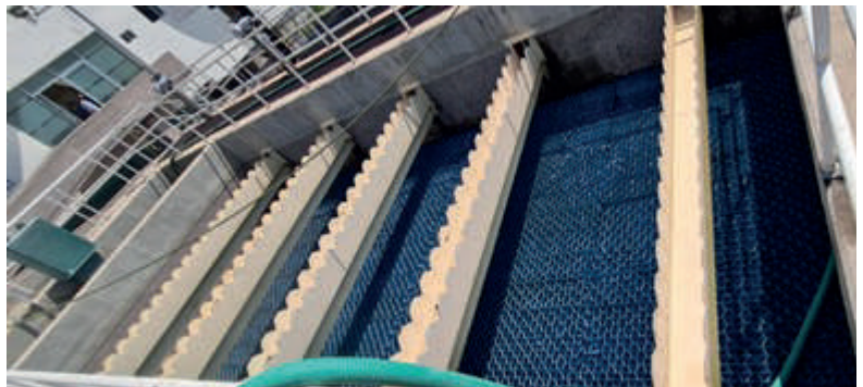
Ilustración 7. Mantenimiento a modulo 3
