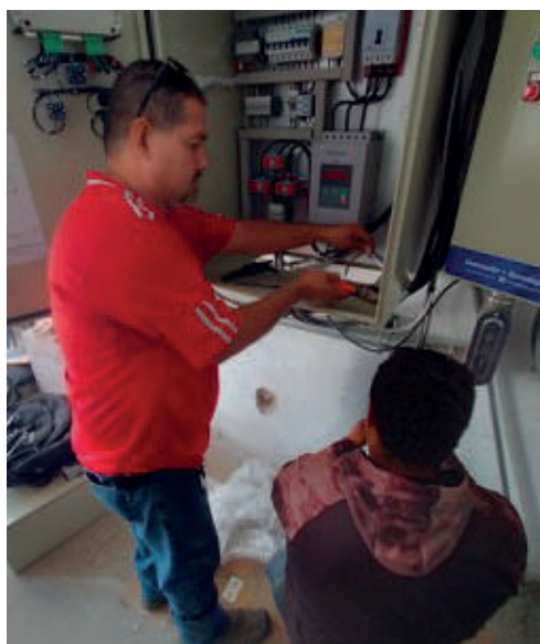
Instalación de arrancador de 50 hp en rebombeo Pemex
