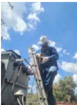
Revisiones en subestaciones eléctricas
