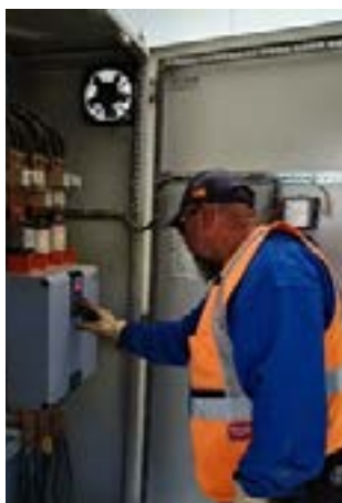
Mantenimiento de arrancadores suaves
